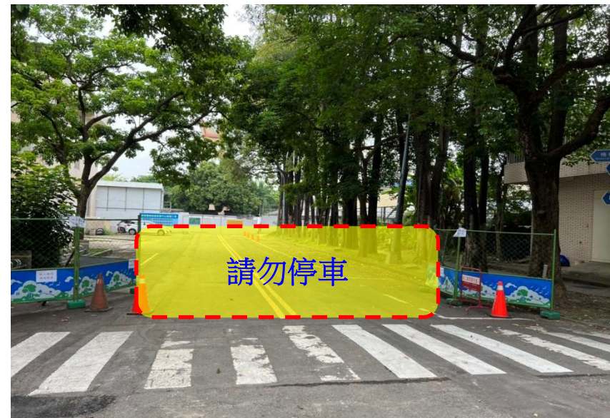
【智慧機械技術研發中心新建工程混凝土澆置作業施工區域現場照片】
